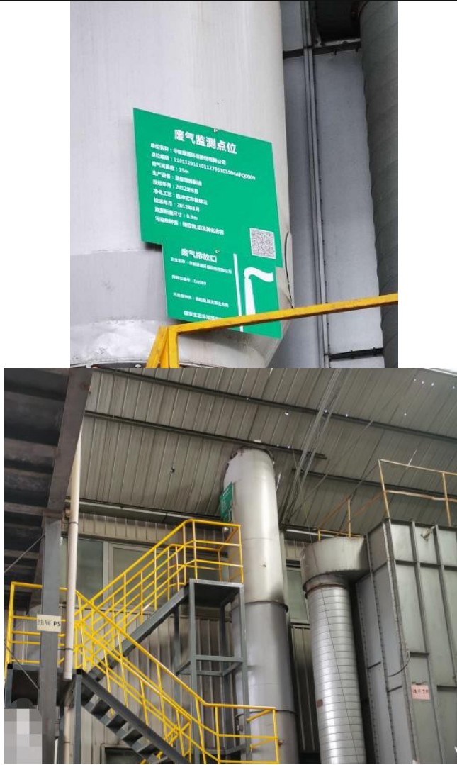
显像管 拆解线 污染防治设施 DA009
